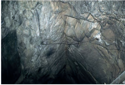
Рис. 1. Место обрушения кровли в подготовительной выработке на Холбинском руднике Fig. 1. Roof fall in development drive in the Kholbin Mine
